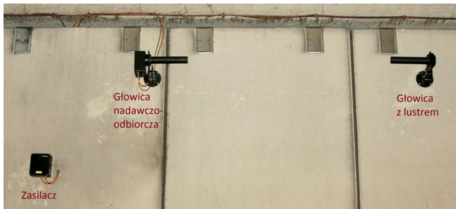
Rysunek 5 : Analizator CO/NO/przejrzystości powietrza zamontowany na ścianie tunelu
